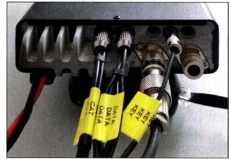
Bild 5: Anschlusskabel DB15-FTMINI8 am Yaesu FT-857D; Tipp: am Mini-DIN-Stecker zeigt die einzelne Kerbe jeweils nach oben.
